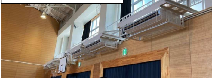
武豊町の小学校体育館空調設備左右に各8機16機がついています。
